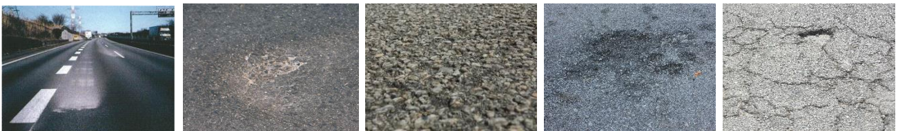
Hình 4 Mặt đường bê tông nhựa bị ảnh hưởng bởi bong tróc
